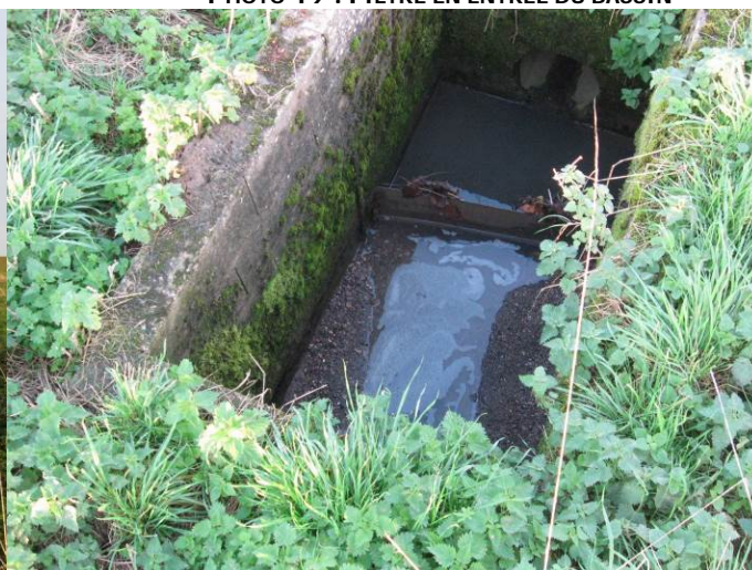
PHOTO 19 : FILTRE EN ENTREE DU BASSIN
