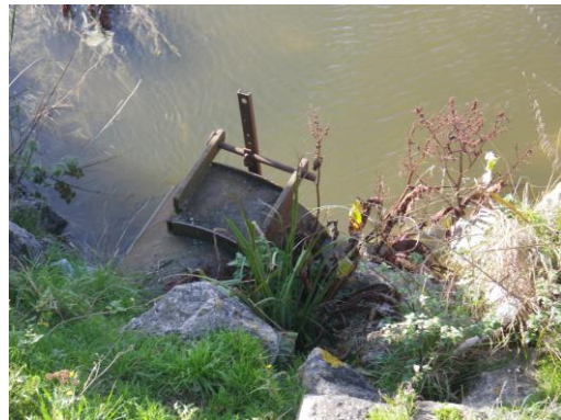
Vanne de l'Enviette à l'exutoire du Hâble d'Ault.
