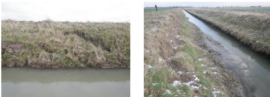
Glissements de berge sur le canal de Cayeux (à gauche) et le canal de Lanchères (à droite).
