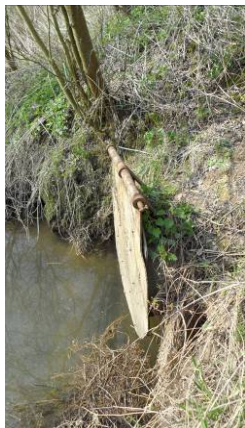
Clapet buse sur le Grand canal à Tigny-Noyelle
