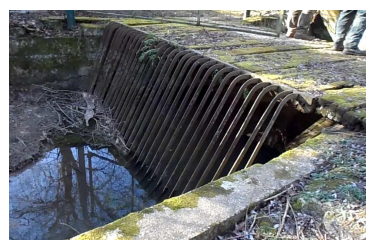
Grille de la prise d'eau
