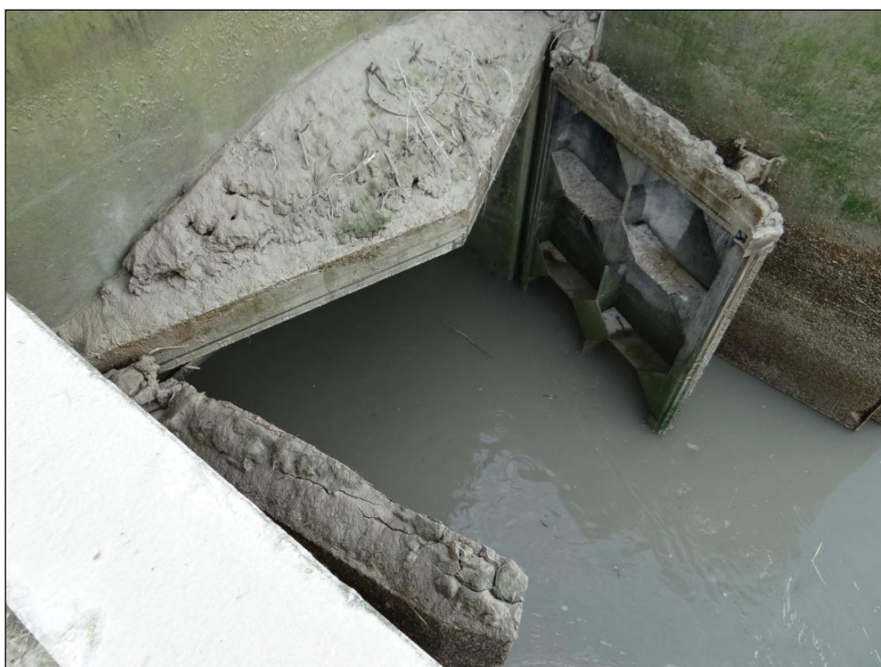
Figure 8 : Photographie de la porte à flot (10/01/2016)
