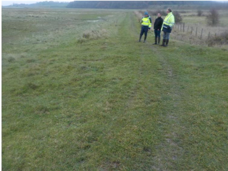
Figure 19 : Changement d'altimétrie de la digue et tassement dû à la circulation ID 61 (27/11/2018)
