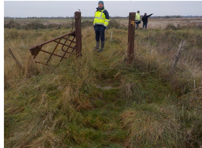
Figure 10 : Barrière en travers de la digue, NB : Barrière à supprimer ID 24 (27/11/2018).
