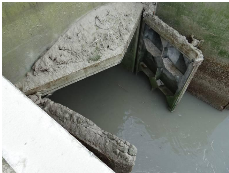
Figure 23 – Contre porte ouverte – 10-01-2017
