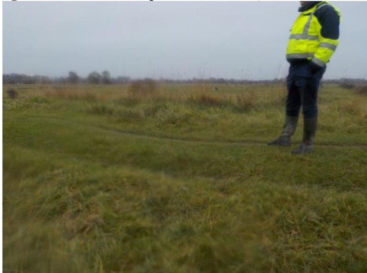
Figure 17 : Tassement de la crête, ID 48 (27/11/2018)
