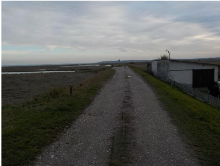
Figure 3 : Tassement de la crête et présence de bâtiments ID 100 (27/11/2018)
