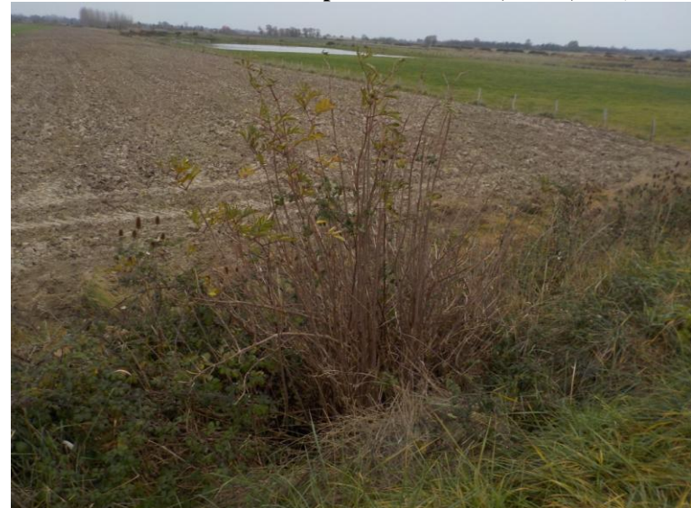
Figure 18 : Arbuste sur le parement interne, ID 38 (27/11/2018)
