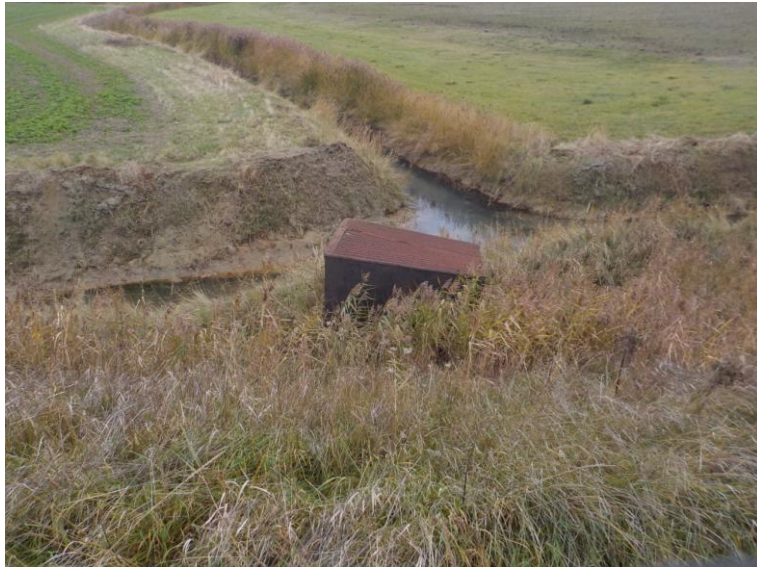
Figure 11 : Cabanon sur le parement interne, ID 27 (27/11/2018)
