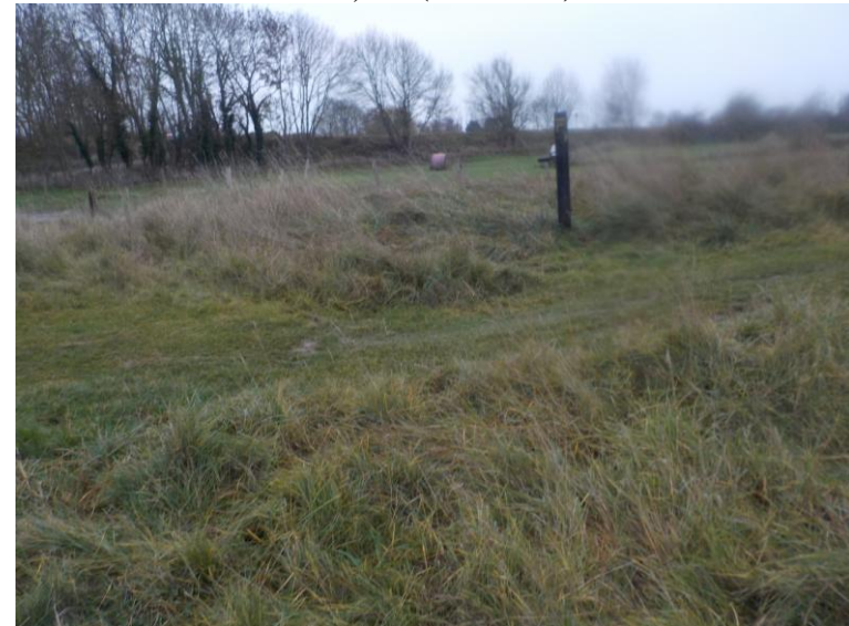
Figure 22 : Tassement de la crête ID 64 (27/11/2018)
