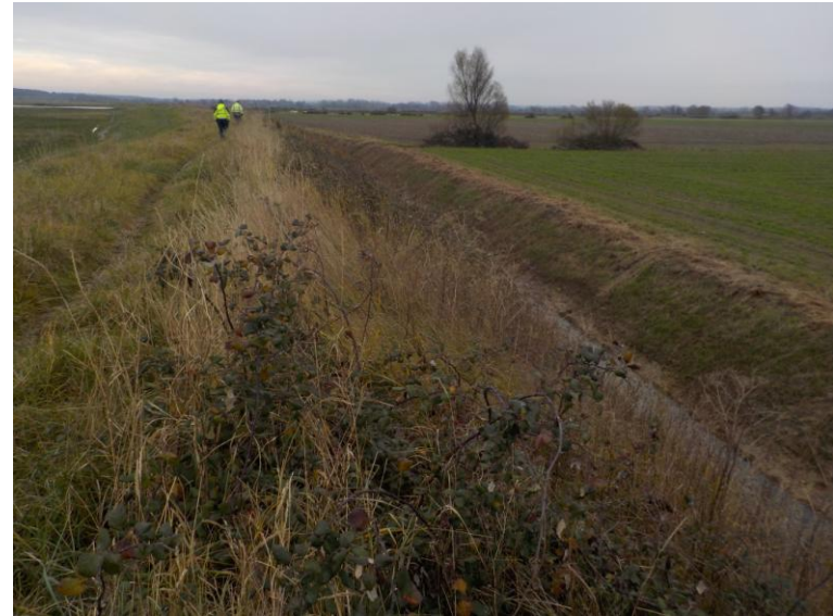
Figure 12 : Ronciers sur le parement interne, ID 111 (27/11/2018)
