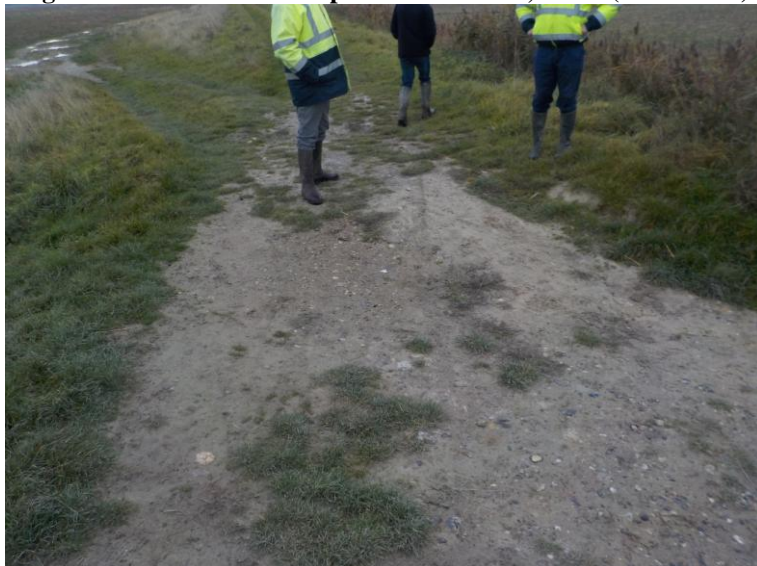
Figure 13 : Tassement dû au passage de véhicules sur le parement externe et la crête, ID 34 (27/11/2018)
