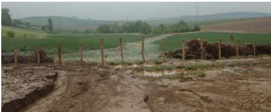
Photo 10 : rupture de fascine par pression hydraulique d'un ruissellement concentré à fort débit
