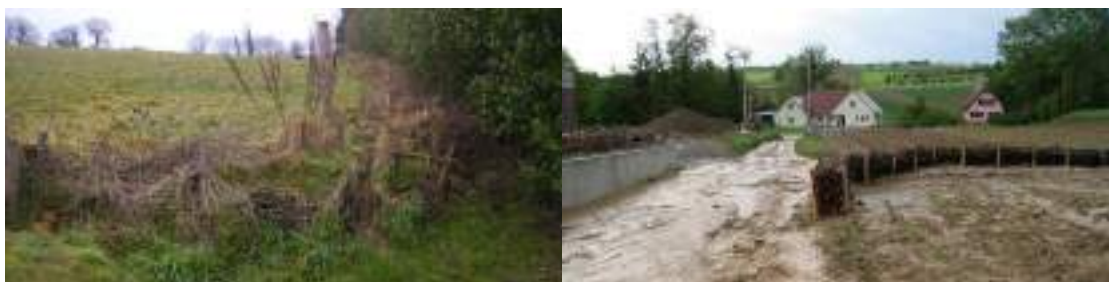
Fascine non entretenue Erreur de positionnement de la fascine Photo 9 : exemples d'erreur de conception et d'entretien
