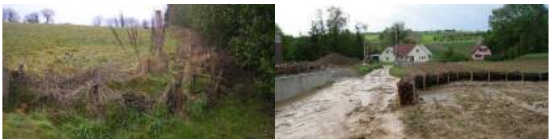
Fascine non entretenue Erreur de positionnement de la fascine Photo 9 : exemples d'erreur de conception et d'entretien
