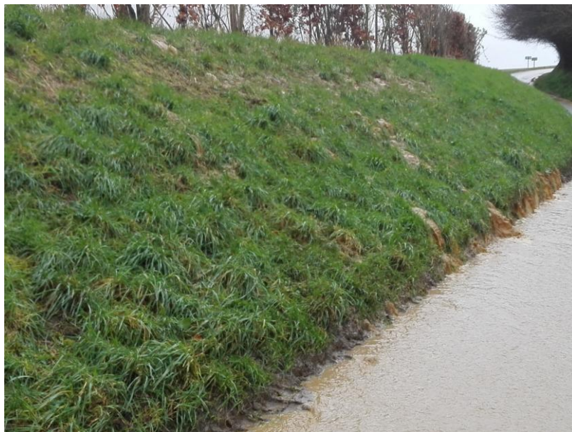
Photo 3 Vue rapprochée (coulée d'eau sur le talus, en provenance d'un champ et malgré la présence d'une haie) Samedi 29/02/2020
