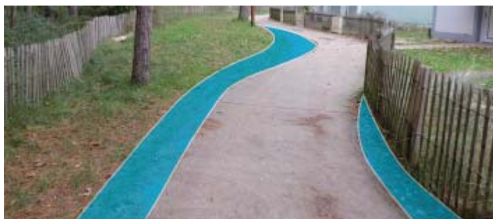
Avant travaux – soulèvement du revêtement causé par les racines (13/06/2018) (Les dégâts causés sur la couche de roulement ont été présentés à la Commission d'enquête lors de sa visite)
