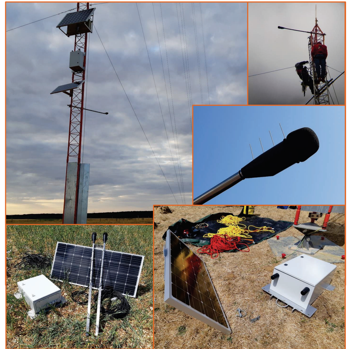
Figure 35 : Illustration photographique du matériel et de l'installation sur le mât de mesure
