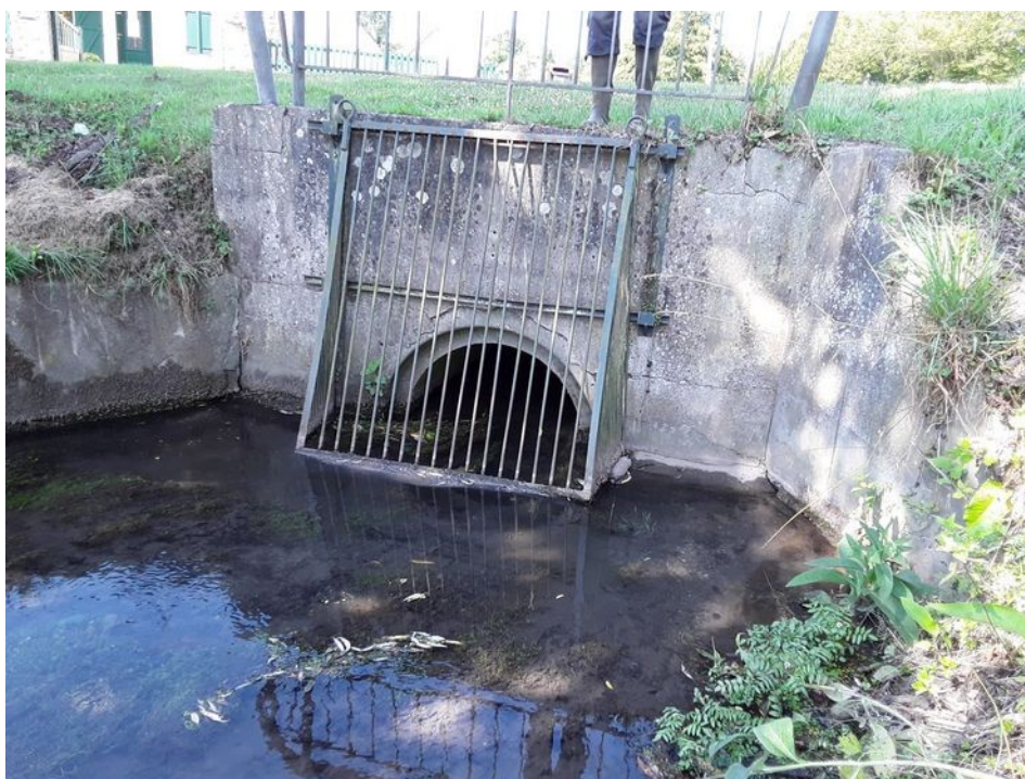
Figure 7 : Engouffrement du fossé au droit de la rue Jules Debuiche
