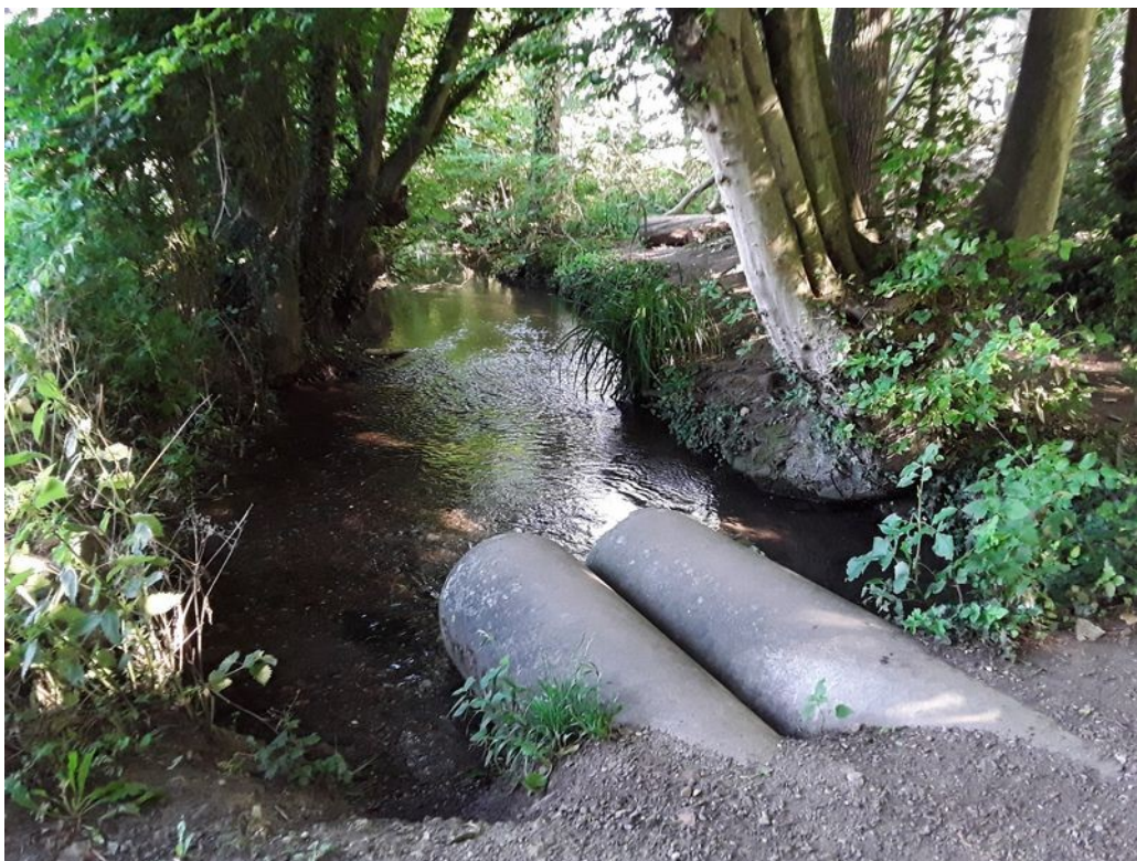
Figure 3 : Fossé Savignac et conduites de diamètre 500 mm sous le chemin Voyeul Watrin
