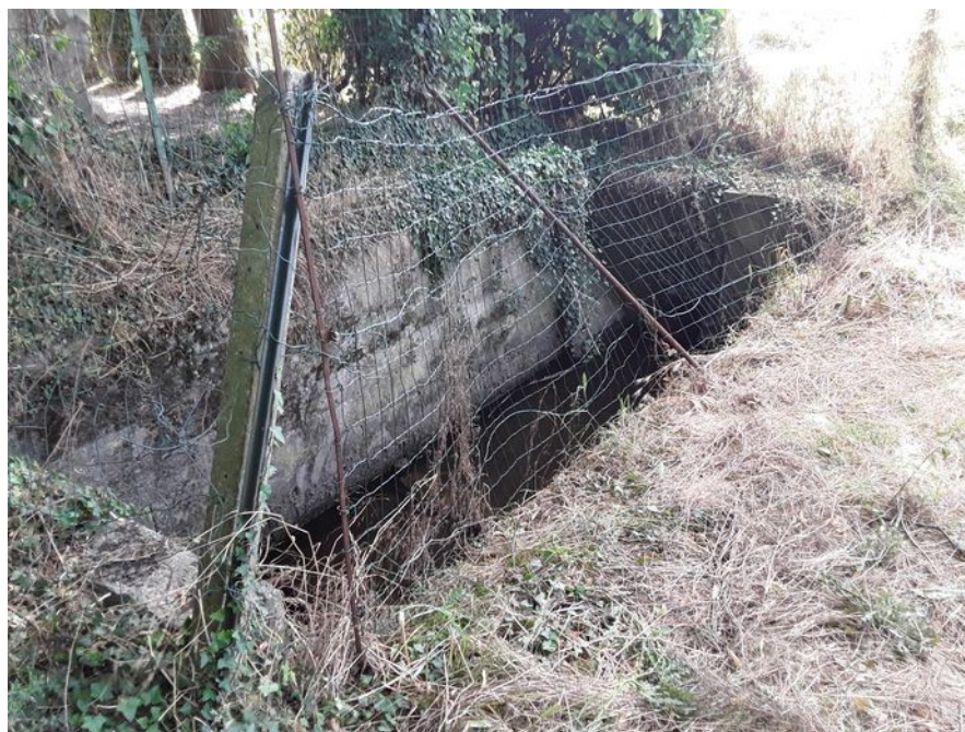
Figure 10: Rejet observé au droit de la grotte de la Vierge
