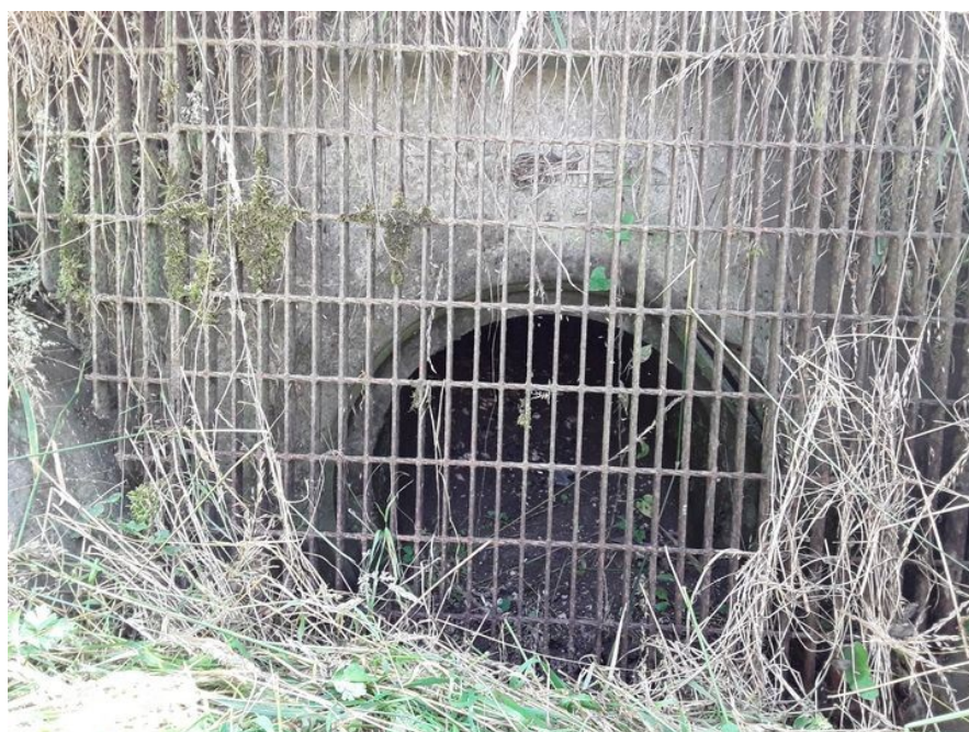
Figure 9: Conduite observée en bout du fossé au droit de la ruelle de l'Église
