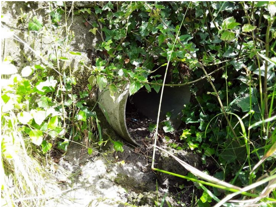
Figure 7: Conduite se rejetant dans le fossé à l'aval de la rue du Château
