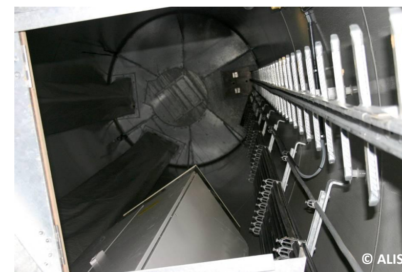
Photo 43 : Intérieur du mât d'une éolienne (échelle d'accès)
