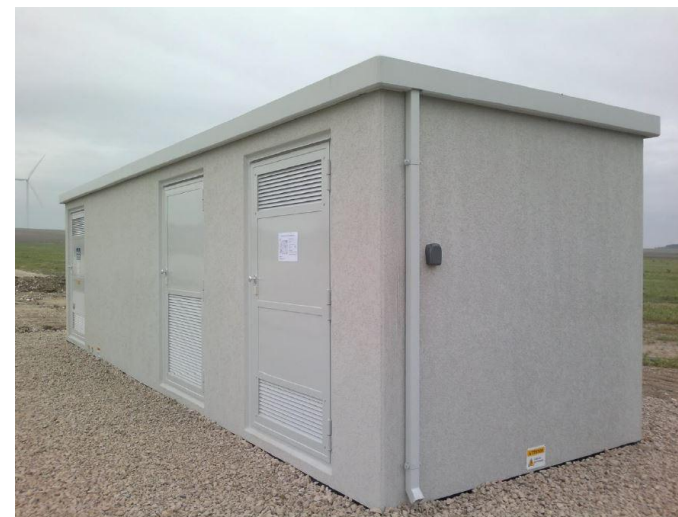
Photo 12 : Exemple de poste de livraison
