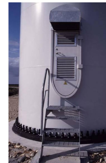
Photo 45 : Transformateur électrique intégré au mât de l'éolienne
